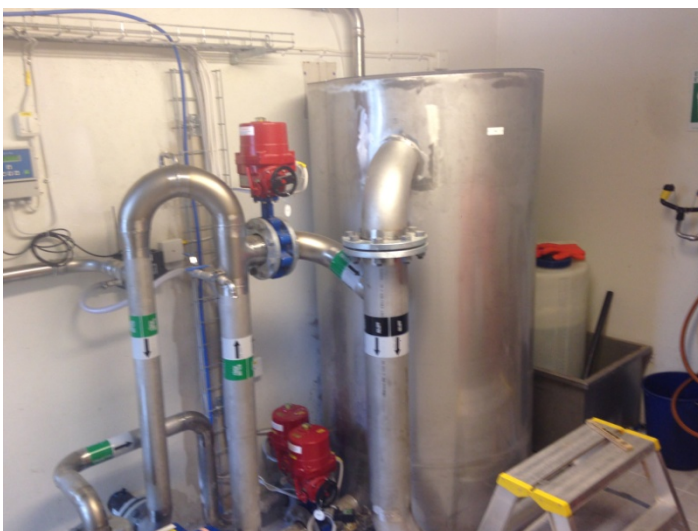
Nytt filter, ventiler och rörgallari i Asped's vattenverk.
